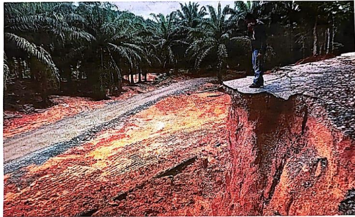
ZAKIMI Zakir Hasim menunjukkan runtuhan jalan utama berketinggian 30 kaki dan laluan alternatif yang dibina atas inisiatif penduduk dan FGV.
