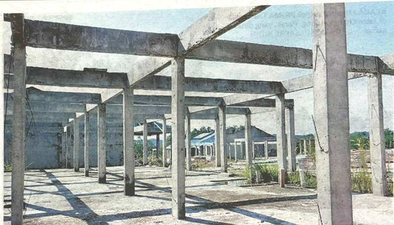
KEADAAN projek PGBF Felda Chini 3, Pekan, Pahang yang terbengkalai ekoran kontraktor bermasalah. - UTUSAN/SHAIKH AHMAD RAZIF
