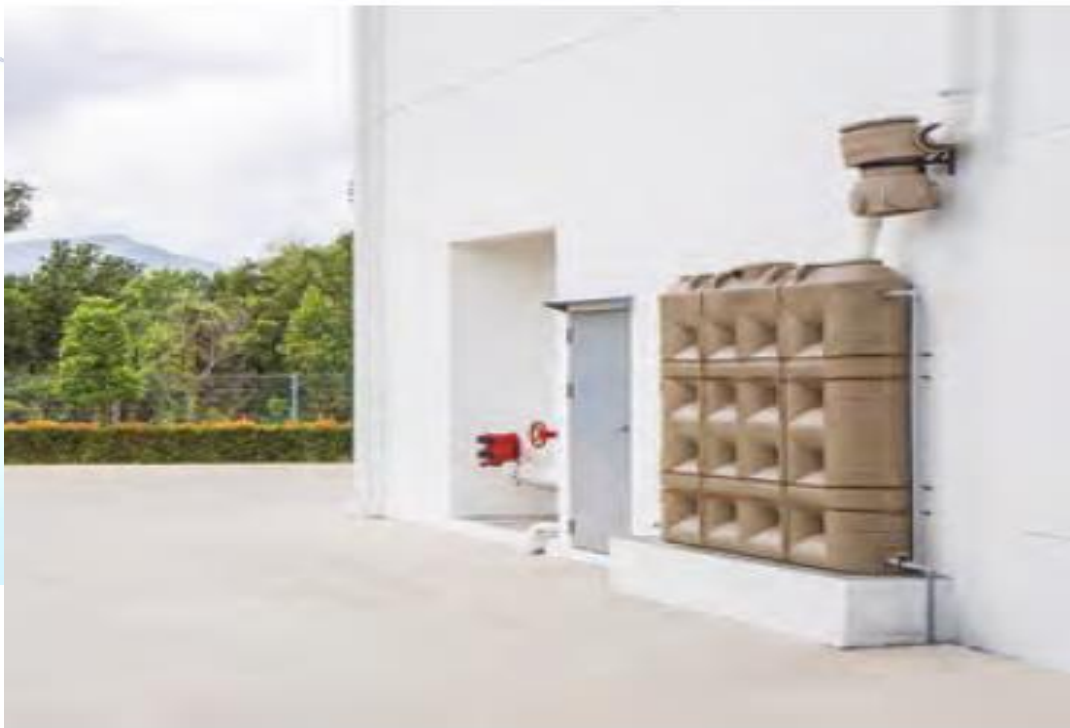
Rajah 7.6 Tangki Penuaian Air Hujan di Kilang i-Park
